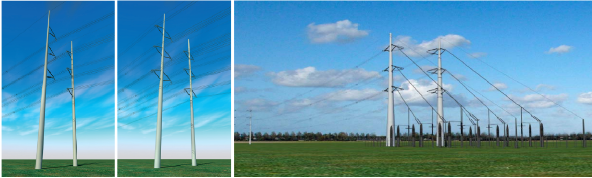
Figuur 2.1. 380 kV mast en combinatiemast 150 kV en 380 kV en opstijgpunt
